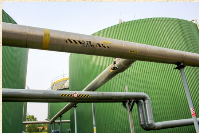
Kromě čištění vody je součástí i výroba bioplynu
